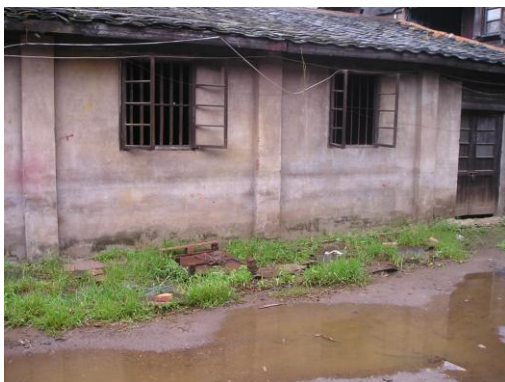
市提升机械厂墙体水渍线
